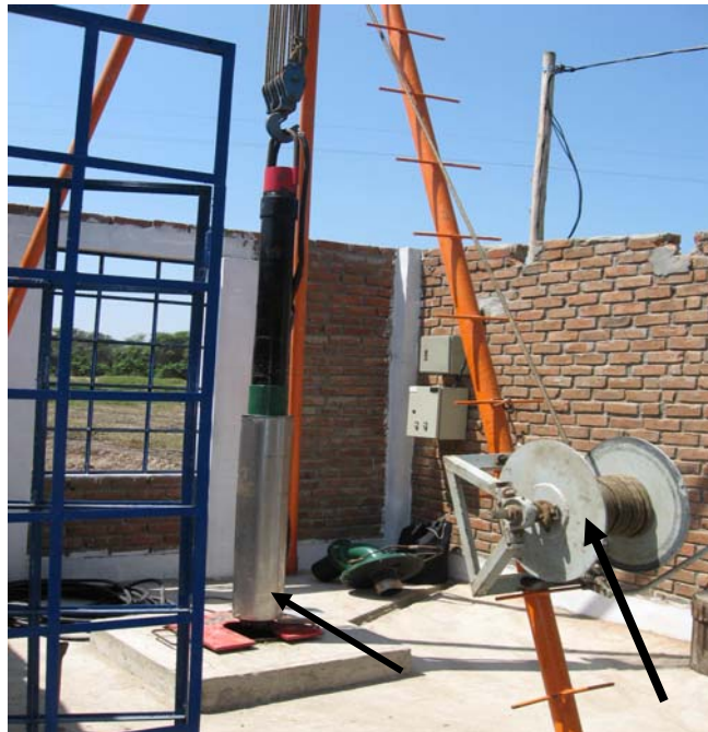
OBSÉRVESE FUNDA O TUBO DE ENFRIAMIENTO EN BOMBA SUMERGIBLE FOTO N° 6
