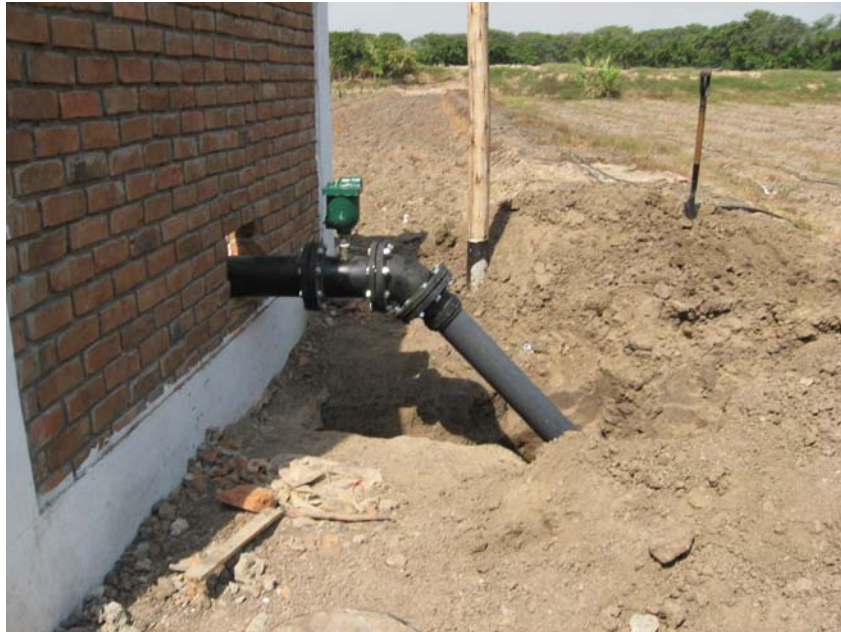
OBSÉRVESE VÁLVULA DE AIRE Y LÍNEA DE IMPULSIÓN FOTO N° 11
