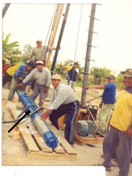
OBSÉRVESE ELECTROBOMBA SUMERGIBLE (VER FLECHA) FOTO N° 3
