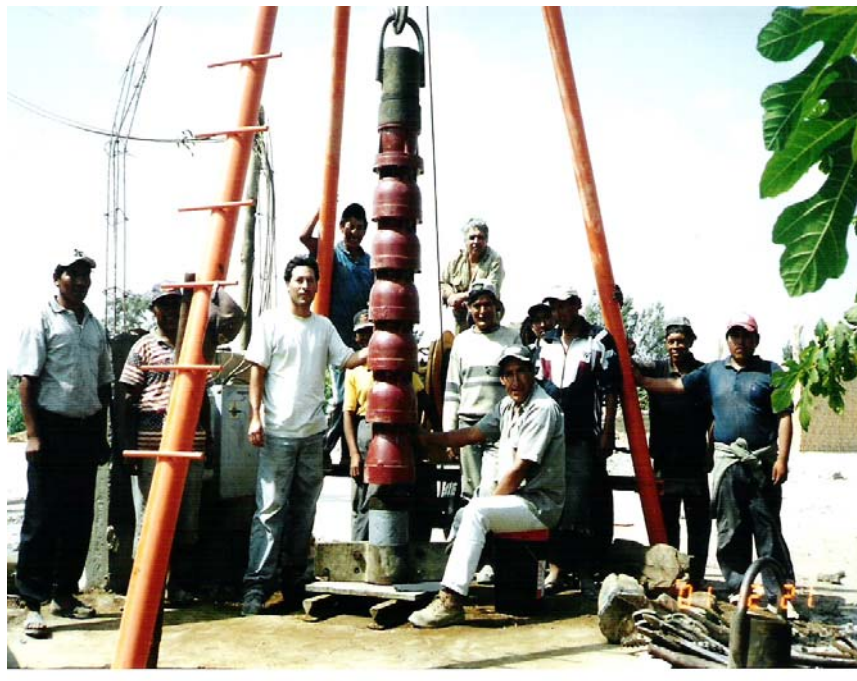
MONTAJE DE CUERPO DE BOMBA TURBINA VERTICAL O DE EJE, DE 5 ETAPAS FOTO N° 19
