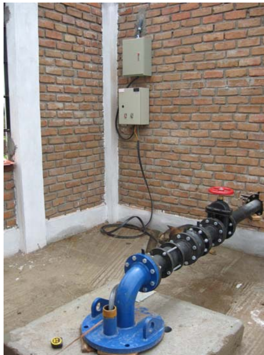
SE PUEDE OBSERVAR LINTERNA, CODO DE DESCARGA Y ÁRBOL DE DESCARGA FOTO N° 10
