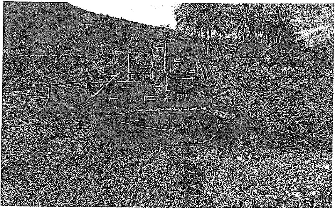
Descolmatación de la quebrada La Lima se observa tractor de Oruga D7, Progresiva 0+200
