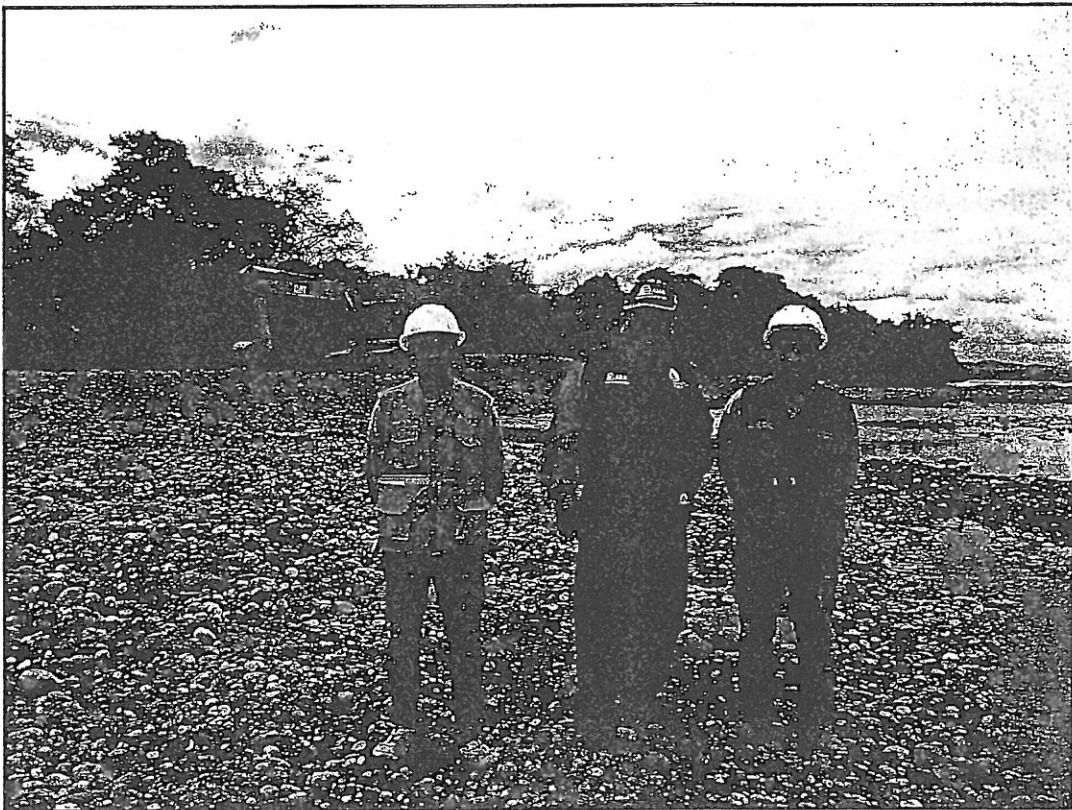
Vista de los trabajos de descolmatación en el río Utcubamba, sector Puerto Nuevo. Acciones de Seguimiento. dic. 2015
