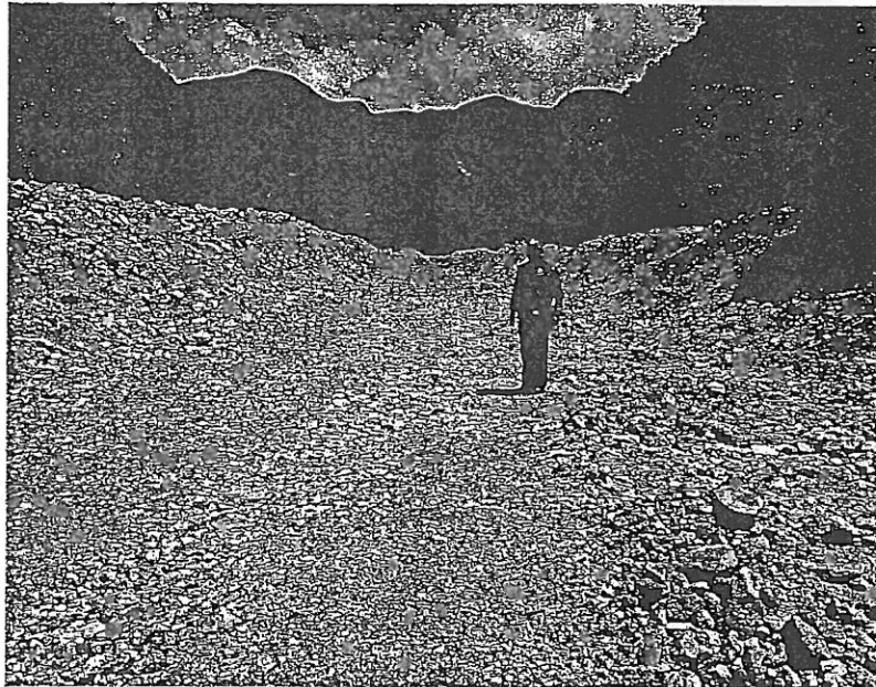
Vista de la descolmatación de la quebrada Seca, en el distrito de Balsas. Dic. 2015
