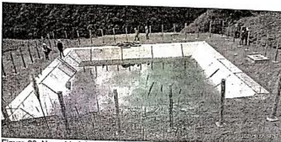
Figura 03: Necesidad de pintado de postes en el cerco perimétrico de reservorios
