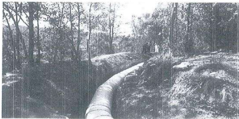
Fotografía N° 10.- Se muestra tubería de la serie S-2, que fueron reemplazadas a la tubería S-1 (previo retiro), sin embargo, a la fecha vienen ejecutando, luego de que el mismo contratista haya presentado la carta resolviendo contrato y fijando la constatación de la obra para el 05 de octubre del 2015.
