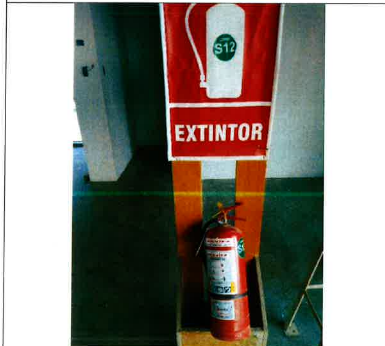
Imagen N° 11. Señaléticas de lucha contra incendios
